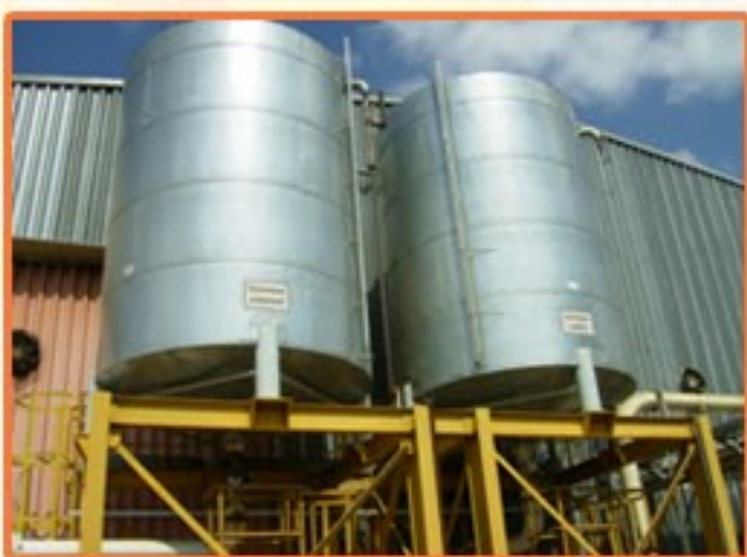
Tanques de calentamiento de agua. Planteados originalmente en el proyecto de "LAVADO DE VENA" (Planta Bigott Chile)
