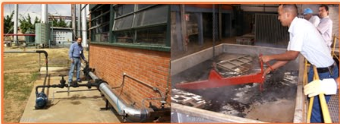
La operación sencilla del equipo calentador de agua IV3-750 optimiza el tiempo de producción ya que llena los tanques en el tiempo deseado y a la temperatura requerida de operación.
